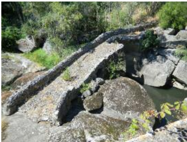
Pont romain très récemment dégradé par le temps © Pierre Aimar
